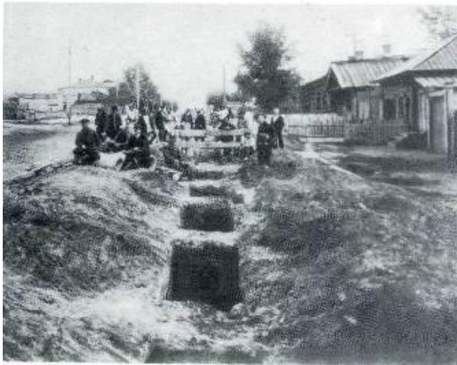
Правый «рукав» ул. Байдукова. Прокладка ливневого желоба. Справа дом Морозовых, ул. Байдукова №83.
