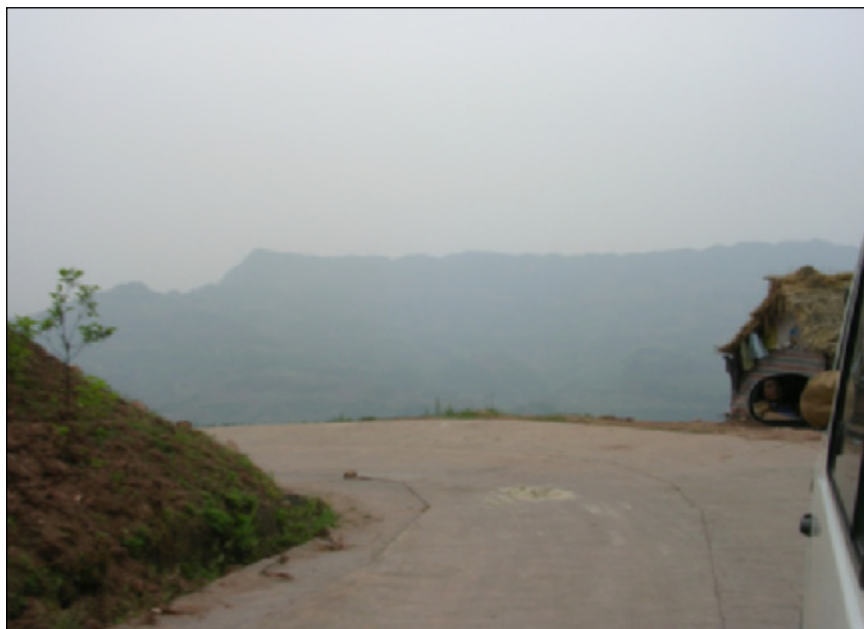
Крутые повороты. Дорога без ограждений.
