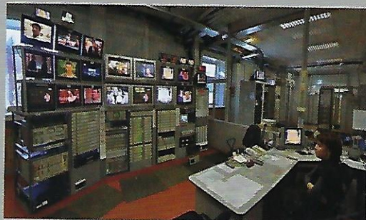
Аппаратная контроля и управления РТРК «Новосибирск».
