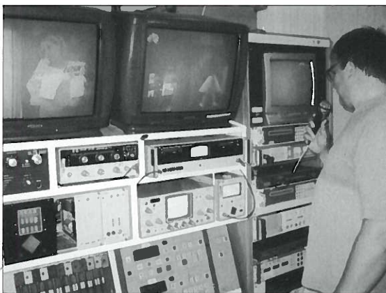
Современное радиотехническое оборудование ЦСС «Матвеевка»
