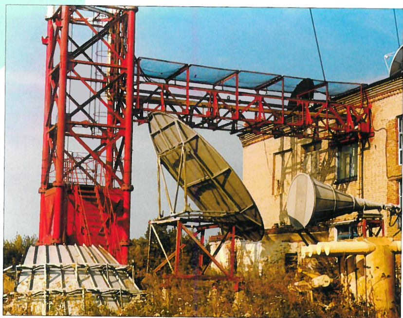
Антенное оборудование РТПС в г. Куйбышеве
