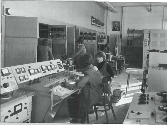
Плановый профилактический осмотр оборудования в ТЗ-1. В центре снимка: начальник смены З. П. Васильева
