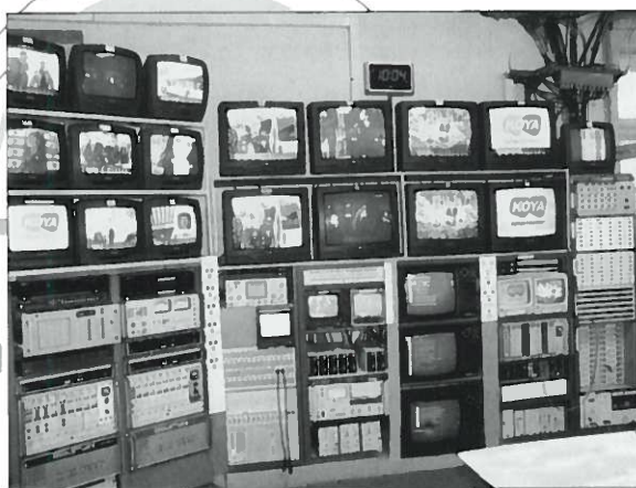
Кабина контроля и управления цеха РТПС «Новосибирск»
