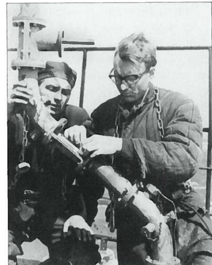
Начальник цеха РТПС «Новосибирск» В. К. Нестеров с помощником производят осмотр фидерного устройства
